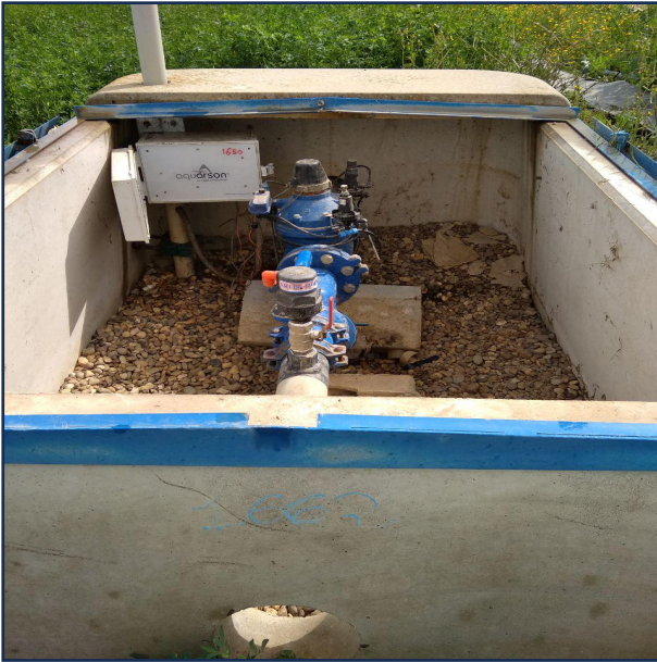
Tomas de riego individuales con caudalímetros
