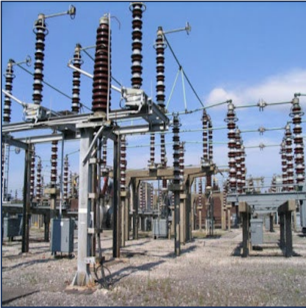
Subestación y Línea Eléctrica
