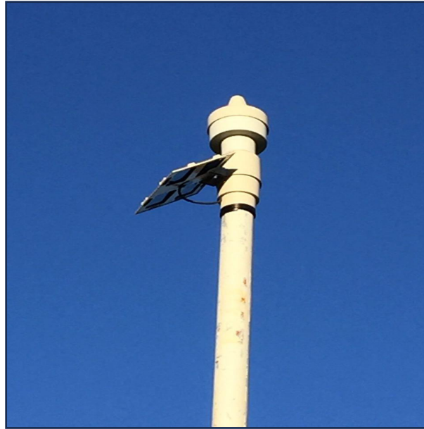
Telecontrol vía radio
