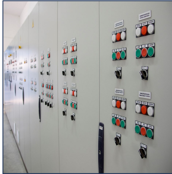
Automatización y control
