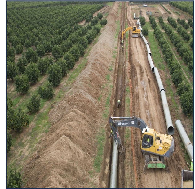
Red de 500 km de tuberías
