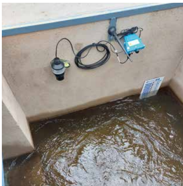
Fotografía 2. Monitorización de volumen captado
