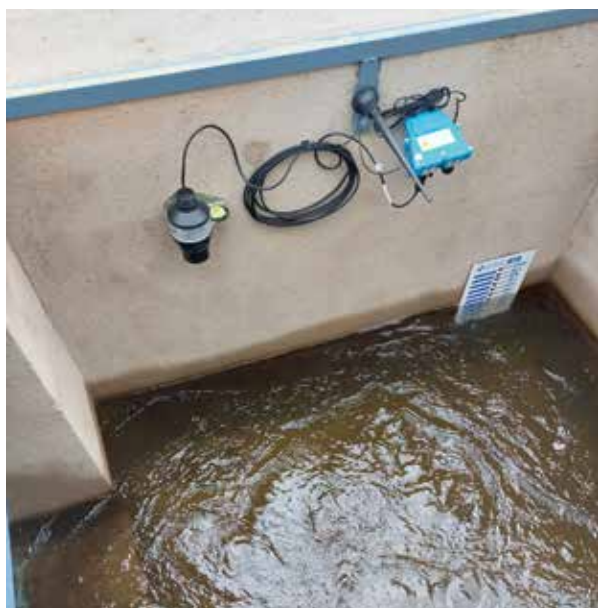
Fotografía 2. Monitorización de volumen captado
